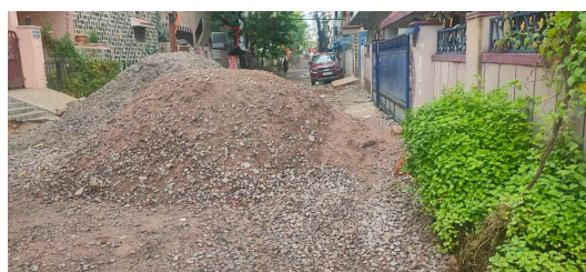
గౌతమీ నగర్ కాలనీలో రోడ్డు అడ్డంగా పోసిన కంకర గుట్టలు..
